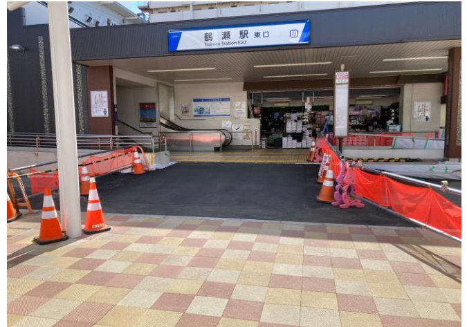
点字ブロックが撤去されたままの東口スロープ
